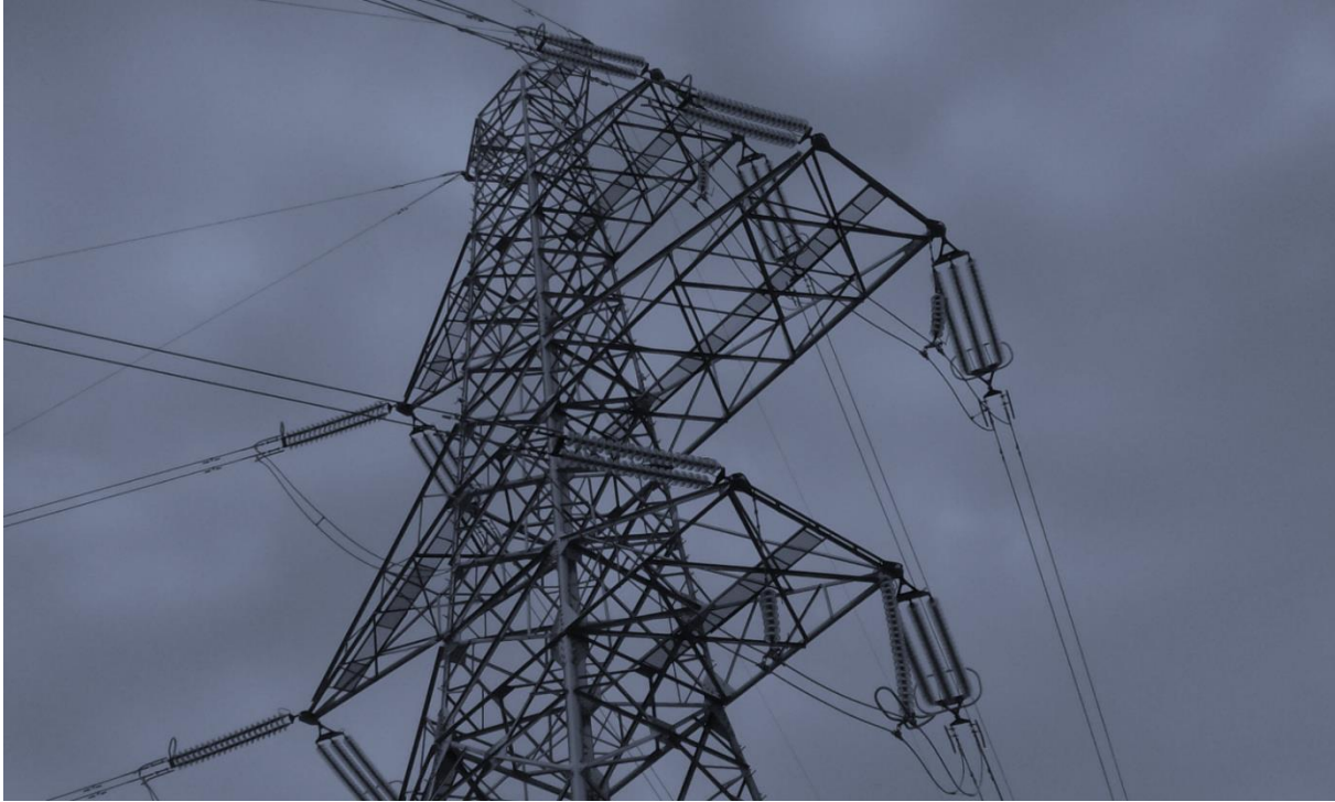
Slika 5: Prihvatni izolatorski lanci 110 kV sa zaštitnim iskrištima na zateznom stubu
